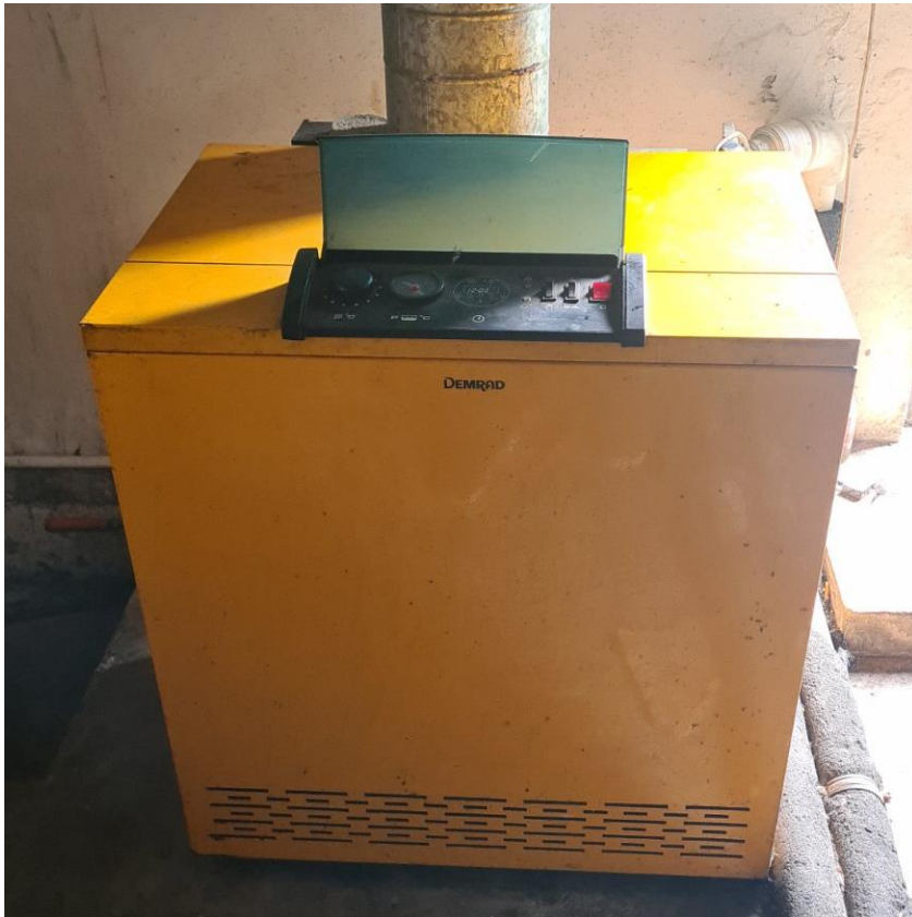
სურათი 3.9. ბუნებრივ აირზე მომუშავე საქვაბე.
