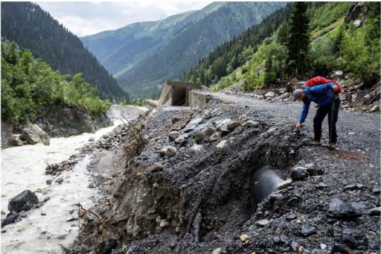
სურ. 7-4: გამიშვლებული სადაწნეო მილსადენი მდებარეობს პირდაპირ არხის მოხრილ მონაკვეთში, ეს ადგილი განსაკუთრებით ექვემდებარება შესაძლო ეროზიას (რესინგერის ფოტო 2020).
